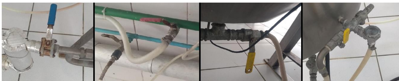
Figura 2 - Válvulas: V1, Vermelha, V5 e PSV1, respectivamente.
